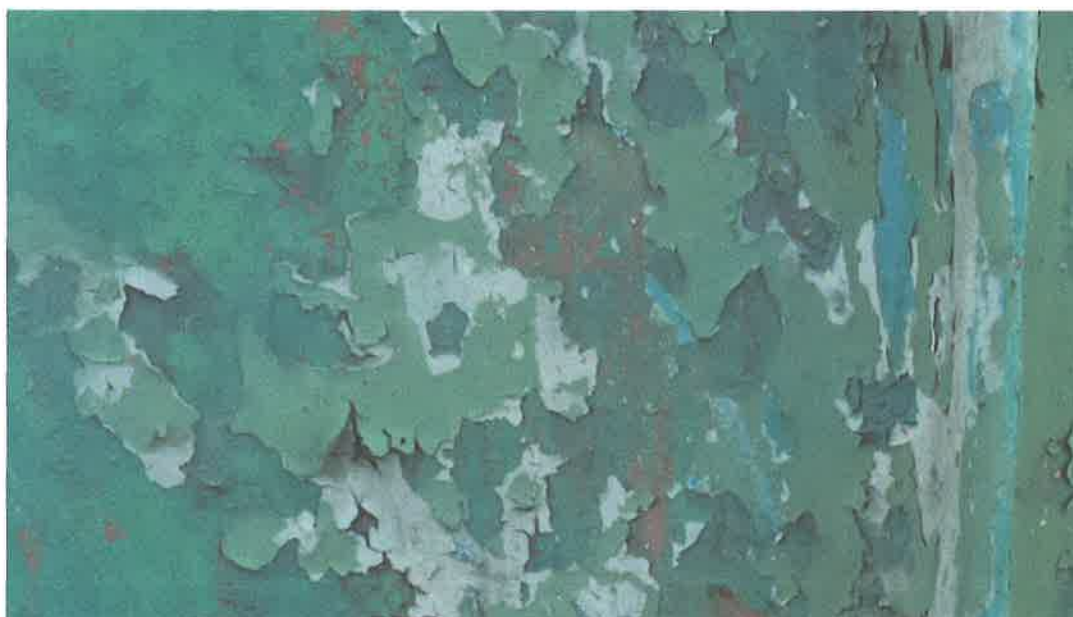
6.FOTOATTĒLS . Lielā torņa jumta A plaknes krāsu slāņi
